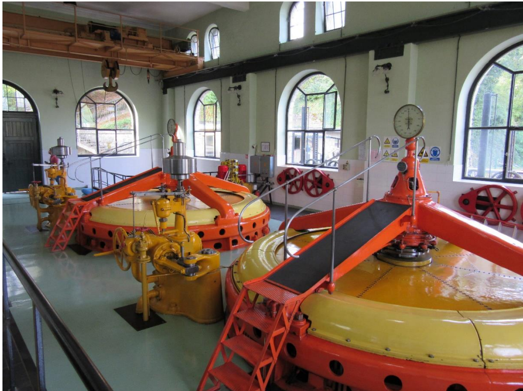
Slika 10.2 Unutrašnjost strojarnice HE Ozalj 1
